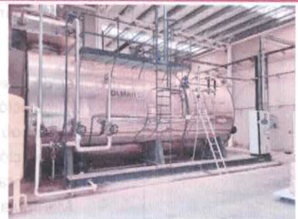
Sala de calderas
