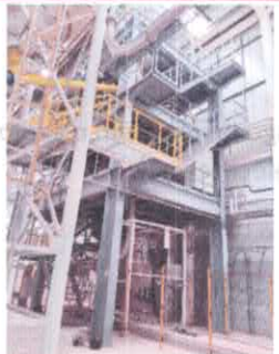
Zona de torre de mezclado
