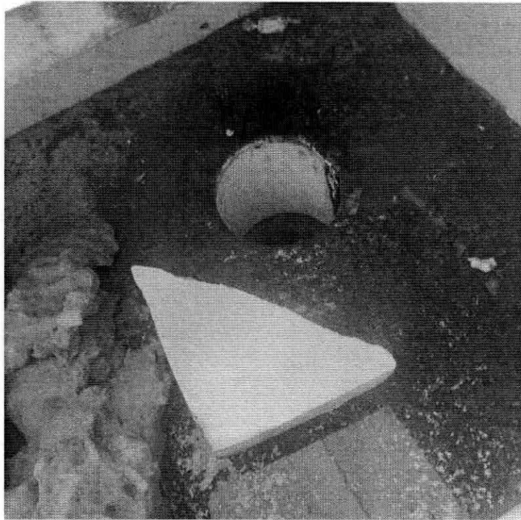
Falta de mantenimiento y limpieza, restos taponando salida de agua a bajantes.
